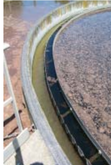
Figure 9 – Flottants de dénitrification en surface du clarificateur
