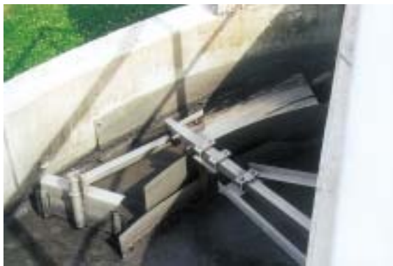
Figure 21 – Système de raclage d'un dégazeur
