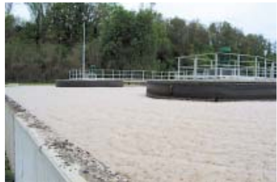
Figure 6 – Mousse biologique en surface de bassin d'aération
