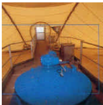
Tour de lavage
