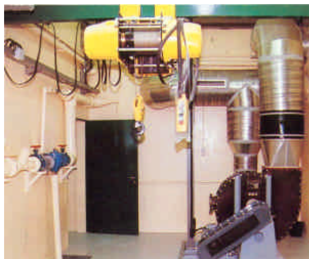
Poste de ventilation
