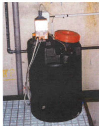
Pompe doseuse de chlore
