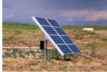
Photo 1 – Alimentation du poste de relevage d'une station d'épuration – Ouzouer le Marche (41) – Réalisation VERGNET
