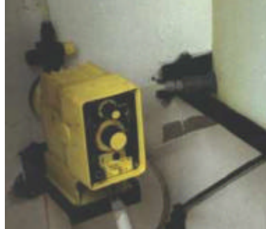
Photo 3 – Pompe doseuse de chlore – Farinole (2A) – Réalisation SOLECO
